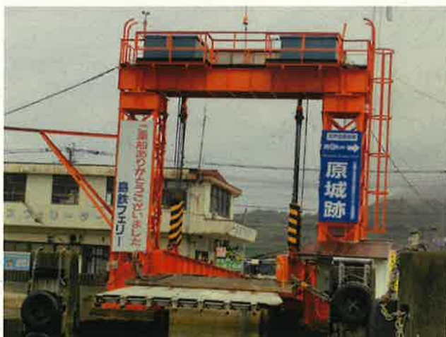
▲【整備前】可動橋老朽化状況
