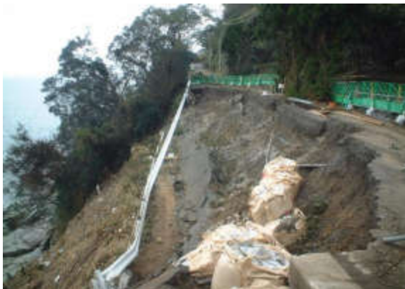
平成18年9月の豪雨による旧道の被災状況
