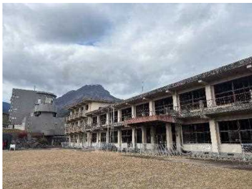
旧大野木場小学校と大野木場砂防みらい館 (大野木場監視所)と平成新山 校舎1階の校長室は、金庫搬出のため、被災後 に窓枠を撤去してある。
