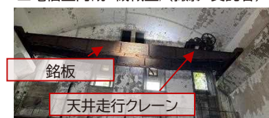
▲電信室内観 機械室天井走行クレーン/(撮影:受託者)
