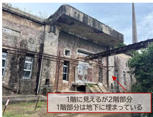
▲電信室外観/(撮影:受託者)
