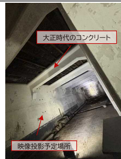
▲電信室内観 整流器室/(撮影:受託者)
