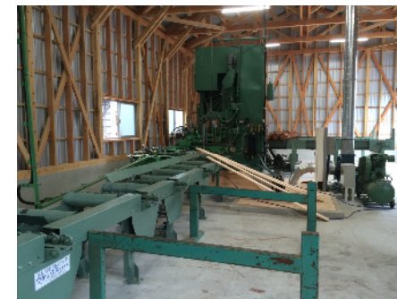
高性能設備への転換 (例：製材施設)
