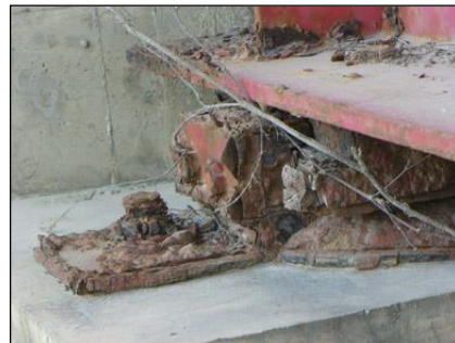
支承-腐食，機能障害
