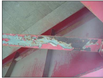
対傾構-防食機能の劣化
