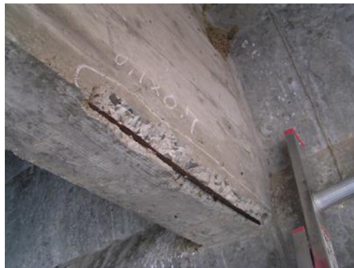
横桁-剥離・鉄筋露出
