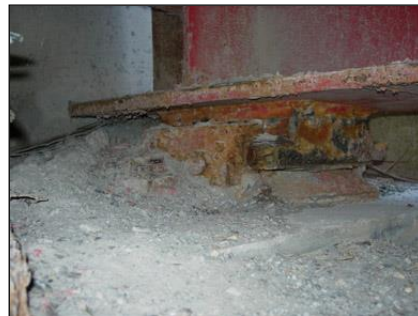
沓座-漏水・帯水，土砂詰り
