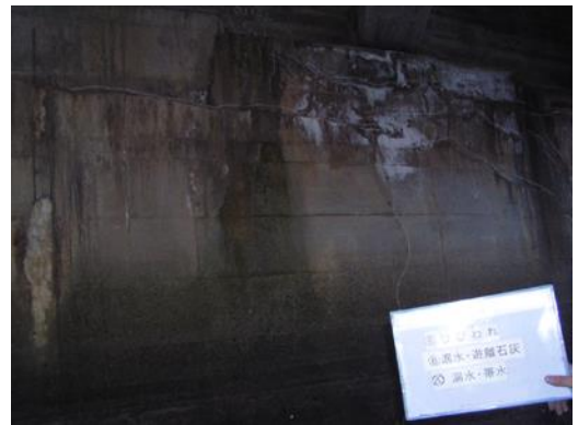
橋台-ひびわれ, 漏水・遊離石灰
