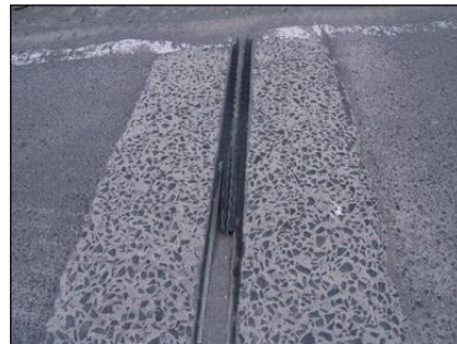
伸縮装置-変色・劣化
