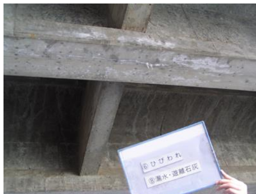
主桁-ひびわれ, 漏水・遊離石灰
