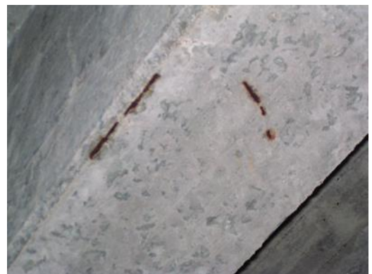
主桁-剥離・鉄筋露出
