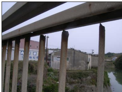
防護柵-腐食，破断
