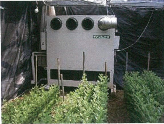
写真1 ヒートポンプ
