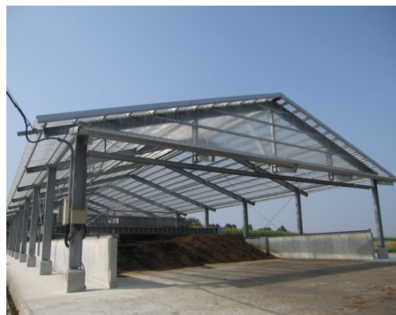
写真 59 畜産研究部門の開放強制攪拌型堆肥化施設
