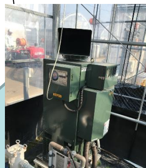
炭酸ガス発生装置とコントローラー
