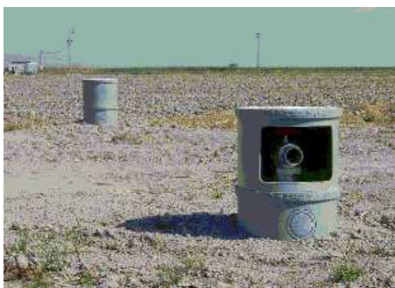
給水栓の整備状況(拡大)
