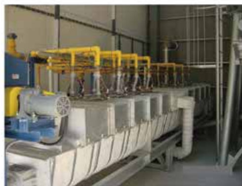
図2 遠赤外線パドルドライヤーの外観
