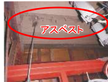
【アスベスト検出状況】
