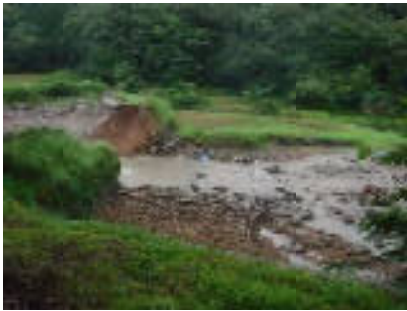
戸井掛ため池 決壊状況
