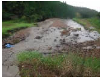
戸井掛ため池 下流農地 被災状況
