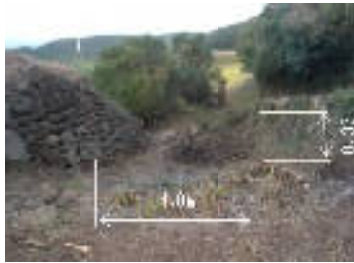
断面が不足し破堤の危険性もある洪水吐
