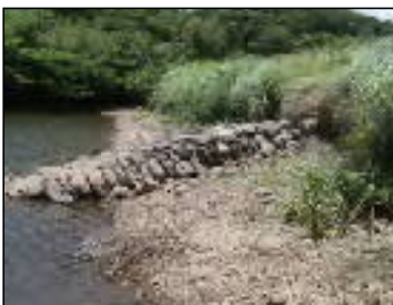
老朽化した取水施設
