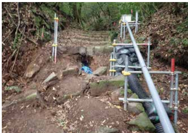
地表伸縮計の設置状況 設置しているワイヤーの伸び縮みにより斜面の動きを観測
