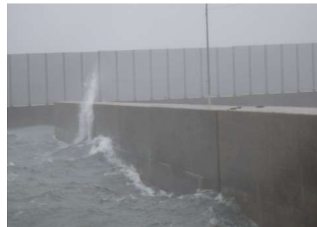
度島漁港 （突堤の越波状況）
