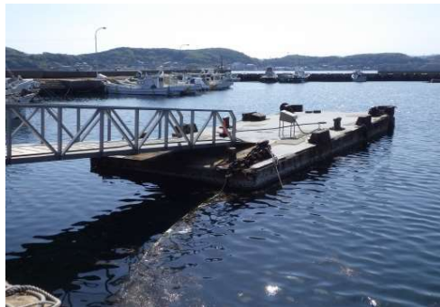
平戸港 （浮棧橋の老朽化）
