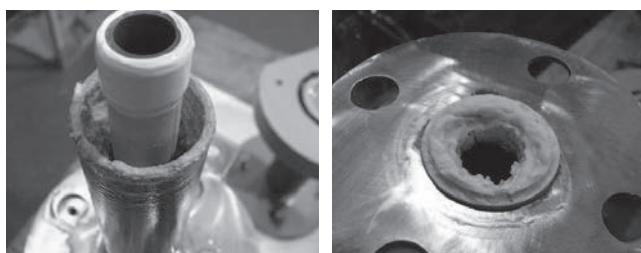
上面（流入口付近）からの視点 下面（流出口付近）からの視点
