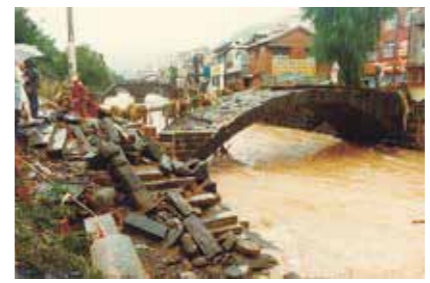
長崎大水害時の被災状況 【中島川袋橋】
