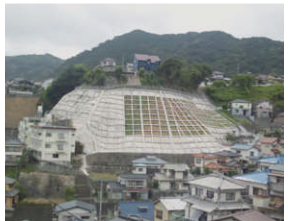
斜面上下部に張付く多くの人家を保全している法面工（長崎市）
